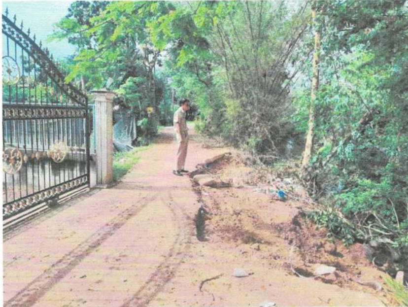
ภาพถ่ายบริเวณถนน คสล.ที่ชำรุดเสียหาย สายข้างลำห้วยเตาเหล็ก หมู่ที่ ๗ บ้านนาโน ก่อนดำเนินการ
